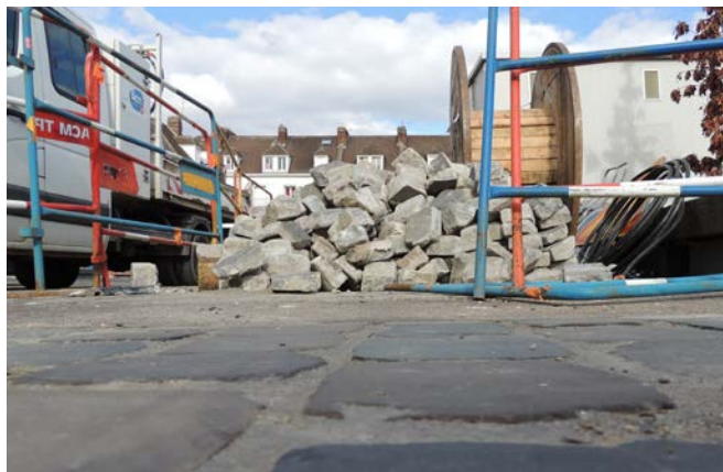
Les travaux mal réalisés aux Douers et place de-Gaulle (photo) ont engendré une dette colossale, dont a malheureusement hérité l'équipe municipale actuelle.
